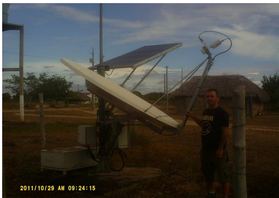
Figura 14 - Painel solar usado em telecomunicações aldeia Campo Alegre (RR). Fonte: Calil Lataiff (2013).
