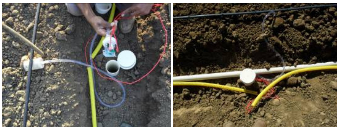
Figura 4. Instalação do acionador em campo.
